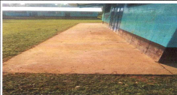
Foto 1: Se observa el deterioro del piso.
