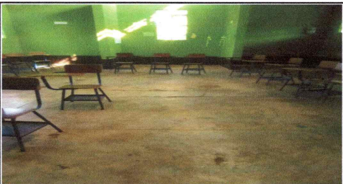
Foto 3: Se observa el deterioro del piso e instalación de cielo falso.
