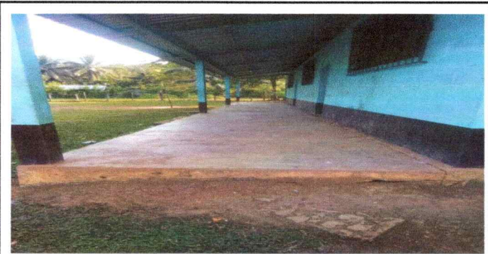
Foto 5: Modulo 2. Se observa el deterioro del piso e instalación de cielo falso.
